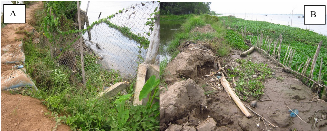
Hình 9: Xói lở bờ sông (A) và người dân đắp kè đất để bảo vệ bờ sông (B)
