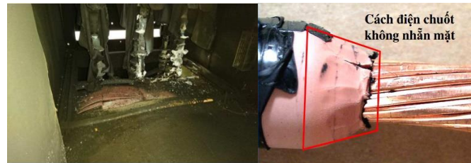
Hình 13. Không đảm bảo khoảng cách pha đất khi lắp đặt đầu cáp trong tủ hợp bộ Sai quy cách thi công cách điện [20].
